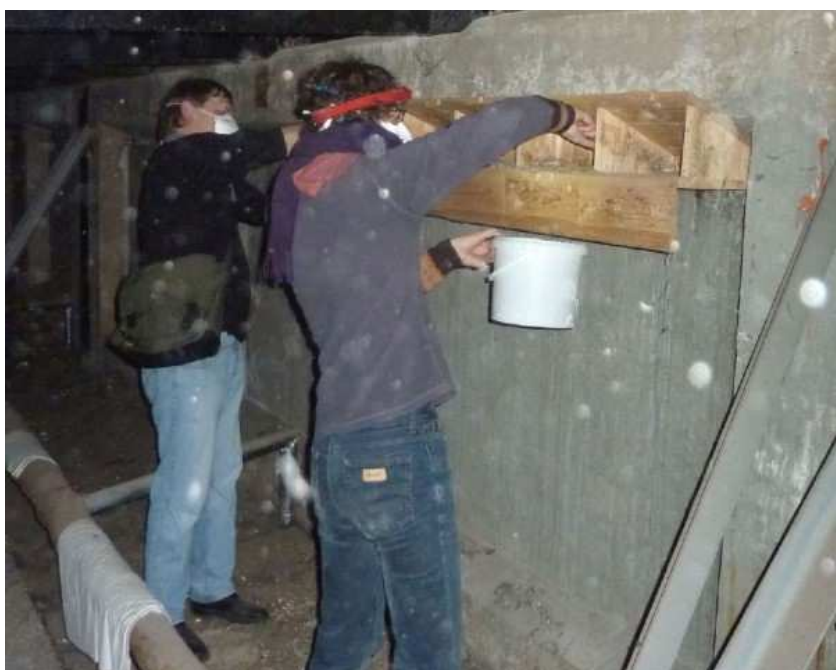
Der Arbeitskreis „Vogelschutz in der Stadt“ hat die Patenschaft für etwa 800 Mauerseglernistkästen übernommen. Viele wurden jahrelang nicht gewartet und mussten dringend repariert werden.
