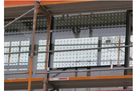
Nach Beratungen mit dem NABU Leipzig wurden bei dieser Glasbrücke an einem Schulgebäude die Scheiben im Siebdruckverfahren bedruckt, sodass sie für Vögel weniger gefährlich sind.
